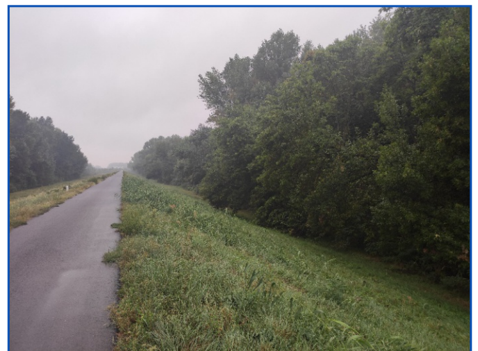
Nem megfelelő állapotú töltéselőtér
