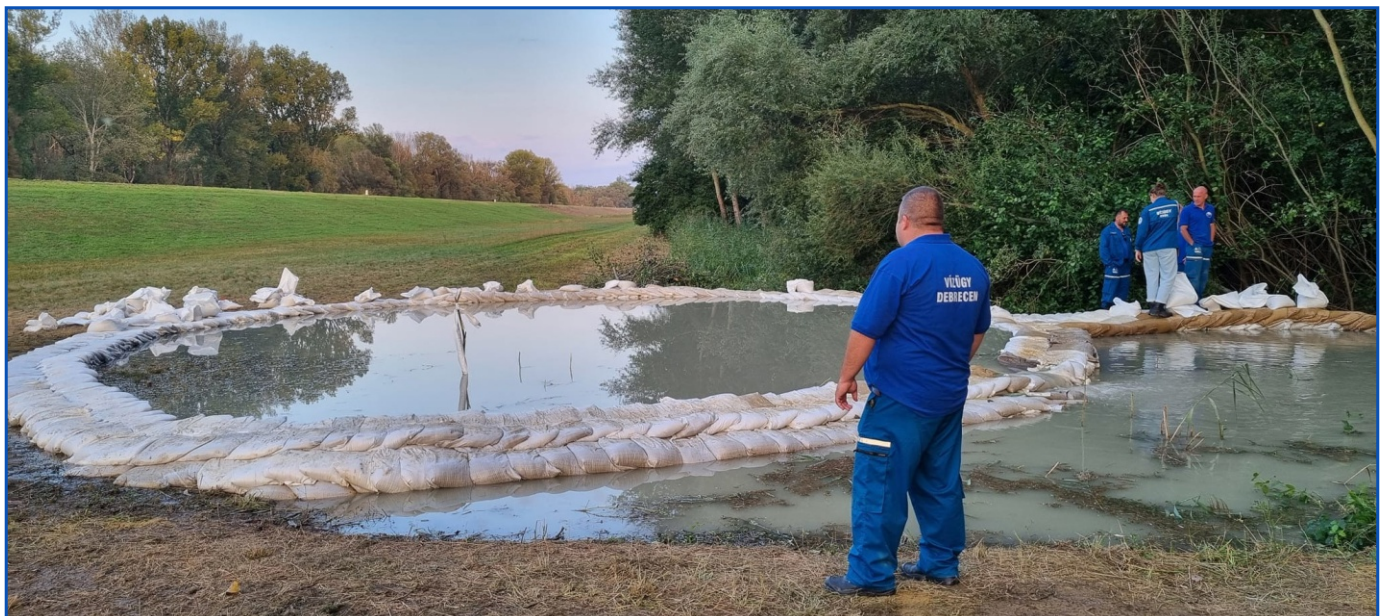
A Mosoni-Duna melletti buzgárt éjjel a Hajdúszoboszlói Szakasz mérnökség munkatársai észlelték napközben a győri szombathelyi és szolnoki kollégák bevédtek
