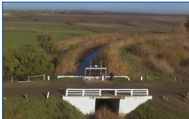
K-III. főcsatorna vízszinttartó műtárgy
