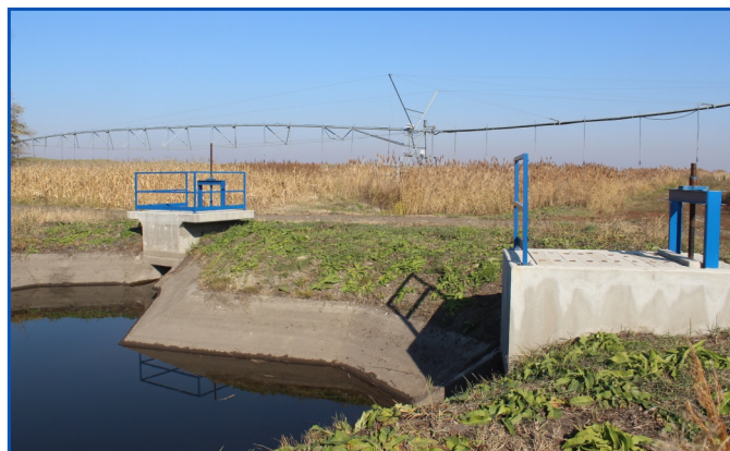
Tiltózható aknás csőáteresz a Derecskei-Kisdülői vízleadó útvonalból
