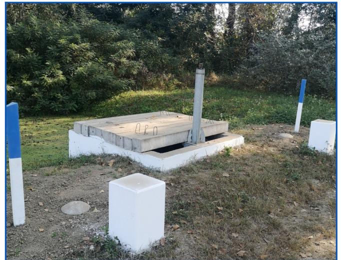
Gomb kialakítású őrpont építése (180122-II. jelű őrpont a K-VIII. főcsatorna beeresztő zsilipénél)
