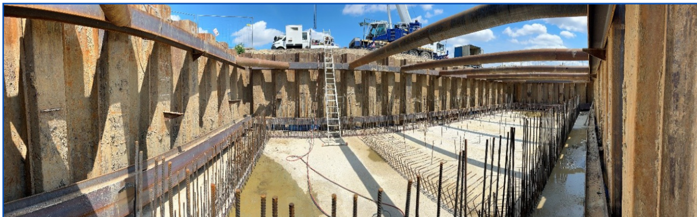
1. kép: Debreceni Déli Gazdasági Övezet bel- és csapadékvíz elvezető mentesítő csatornán áttemelő akna kivitelezéséhez szükséges munkatér-határolás
