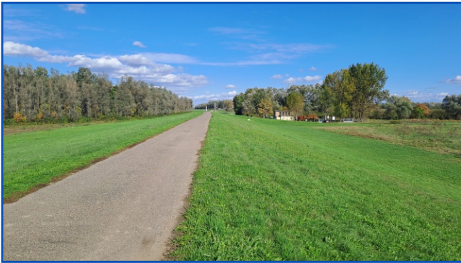
Elsőrendű árvízvédelmi töltés – Tisza bal part, Tiszanagyfalu
