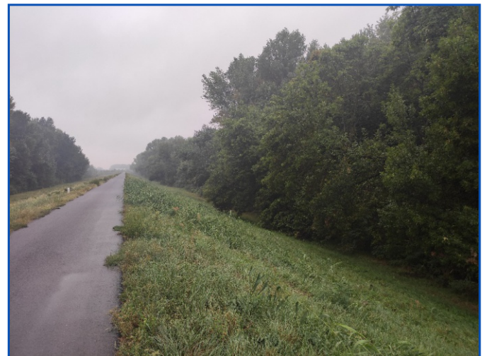
Nem megfelelő állapotú töltéselőtér
